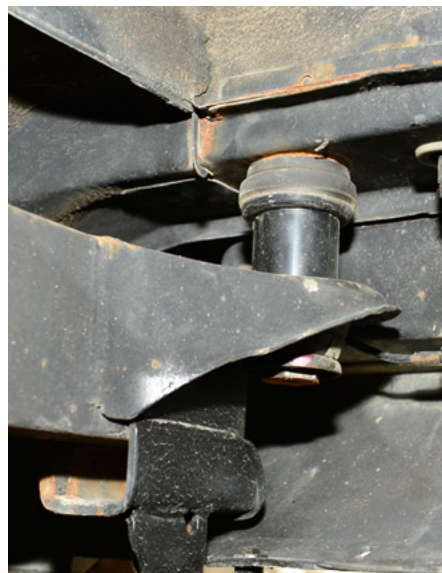
Rahmen und Karosserie sind nun durch Distanzstücke fünf Zentimeter weiter voneinander entfernt. Damit gibt es mehr Platz im Radhaus.
